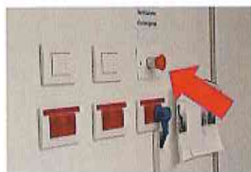
Ventilazione di emergenza in sala magnete
