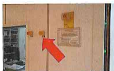
Ventilazione di emergenza in sala magnete
