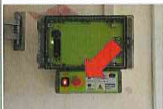
Ventilazione di emergenza in sala comandi
