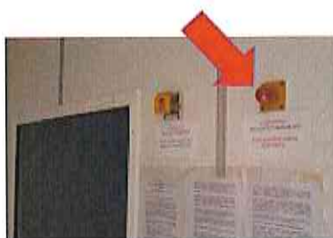
Pulsante di sgancio elettrico in sala magnete
