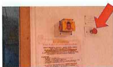
Pulsante di sgancio elettrico in sala magnete
