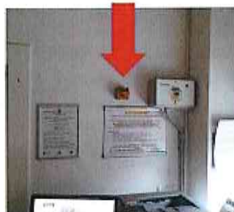
Sgancio elettrico in sala comandi
