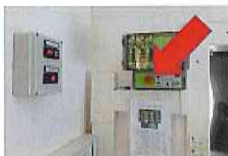
Ventilazione di emergenza in sala comandi
