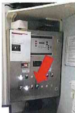
Ventilazione di emergenza in sala comandi
