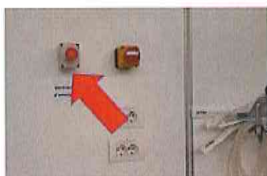
Ventilazione di emergenza in sala magnete
