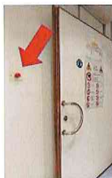
Ventilazione di emergenza in sala magnete
