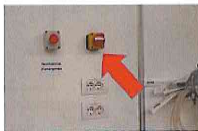
Pulsante di sgancio elettrico in sala magnete
