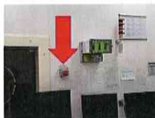
Sgancio elettrico in sala comandi
