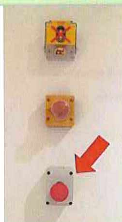
Ventilazione di emergenza in sala magnete
