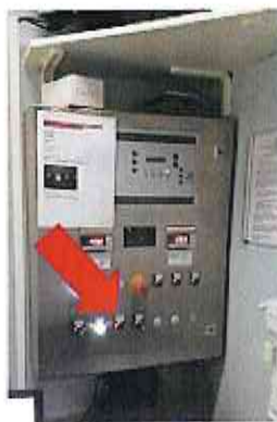
Sgancio elettrico in sala comandi
