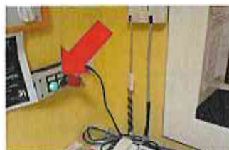
Sgancio elettrico in sala comandi
